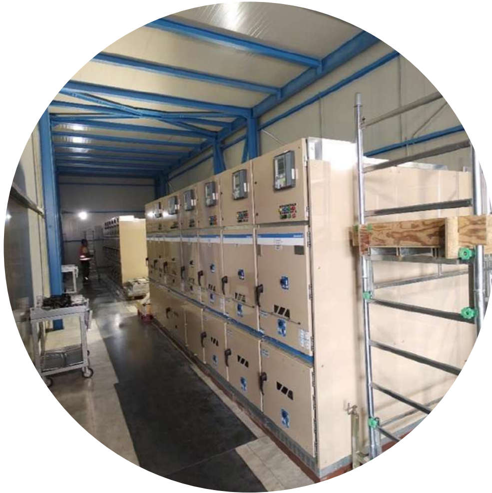
Interno edificio elettrico MT con quadri
